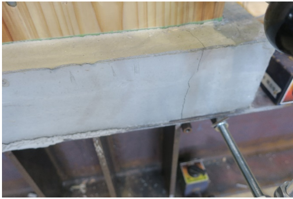
(1) 1/100rad 脚部モルタル割れ
